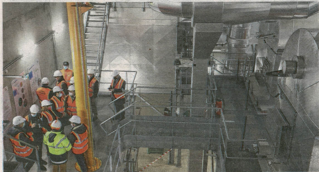
Chacune des chaudières a une puissance de 6 MW, pour distribuer de l'eau chauffée à 100 °C dans un réseau de 14 km et d'ici 2024, de 17 km.
